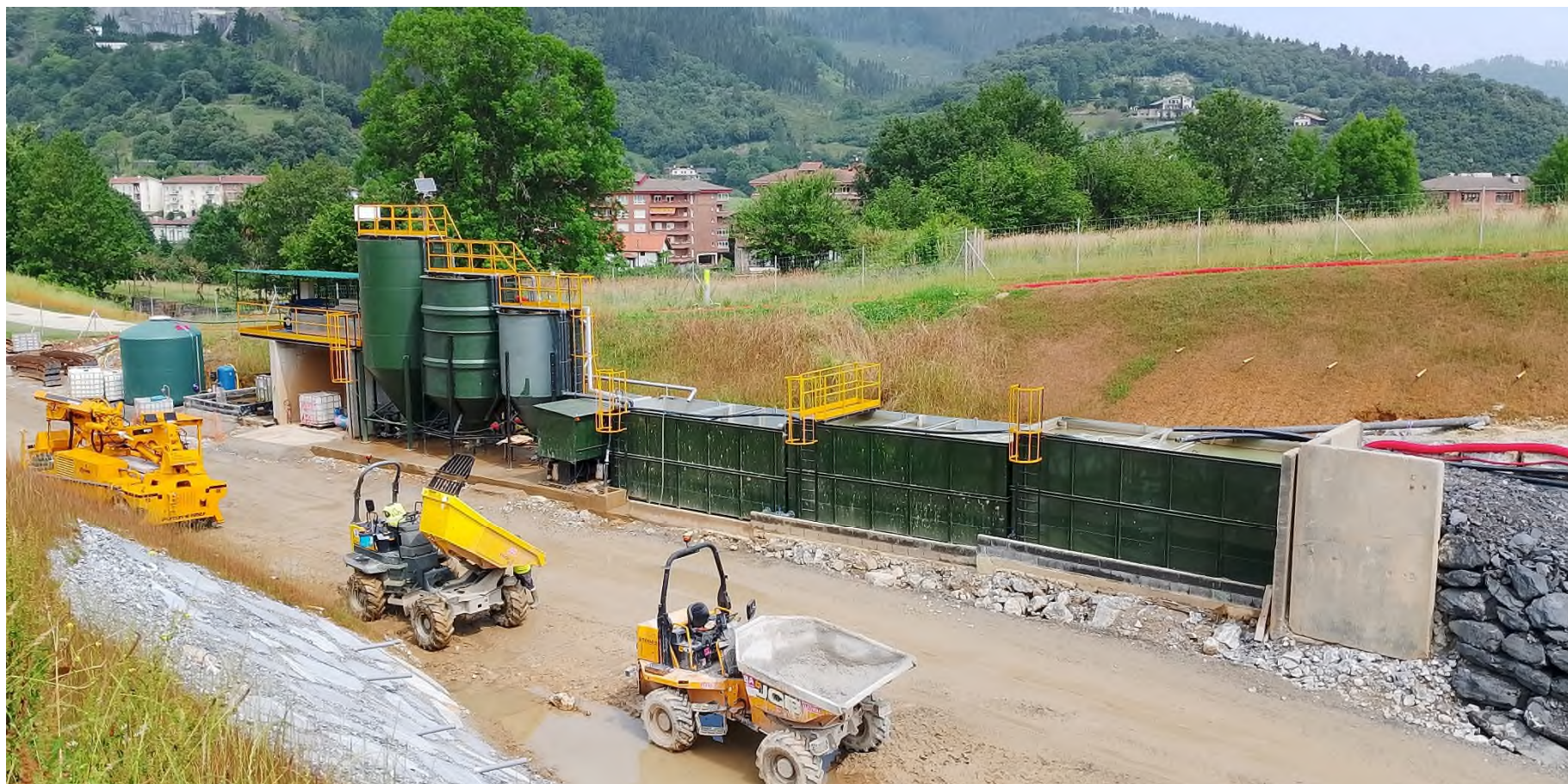
INSTALACION DEPURADORA DE AGUA EN MARKINA
