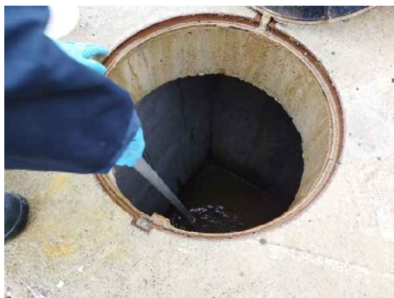
Foto nº20: Arqueta Dren de fondo
