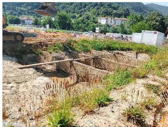
Foto nº2: Balsa de decantación eje-19
