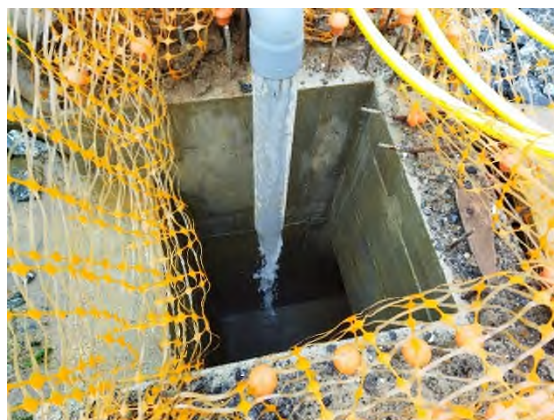
Foto nº18: Vertido de la depuradora
