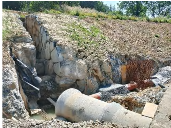
Foto nº6: ODT-01: drenaje y abastecimiento
