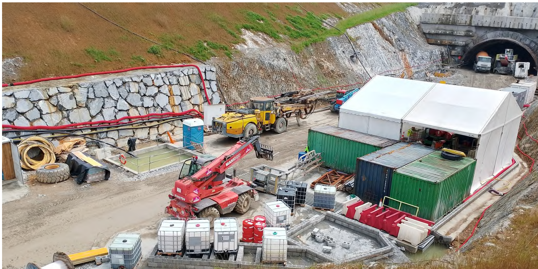
INSTALACIONES AUXILIARES – S4 MARKINA
